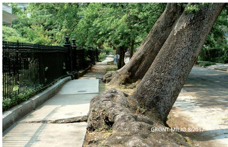
Figur 3. Platanerne mangler støtterødder ud mod vejen. Trækrødderne løfter belægningen og går ind i haven bagved. Foto: Clemens Heidger.
